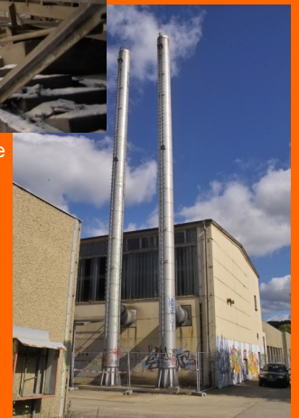
Schornsteinanlage aus Stahl, freistehend
